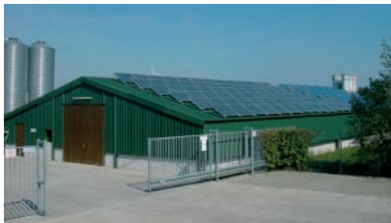
Photovoltaikanlage auf Stalldach
