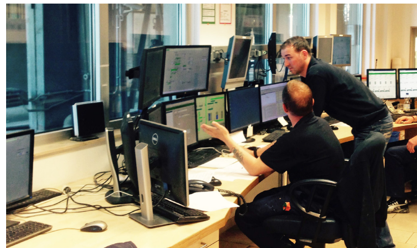
Praxisbeispiel Schaltwarte: Alle Prozesse werden vom neuen Leitsystem gesteuert.
