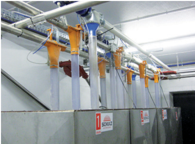
Die Individual-Phasenfütterung ermöglicht die automatische Fütterung mit verschiedenen Futtersorten über eine Futterbahn.
